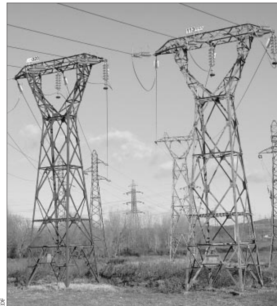
AVANT Une de ces autoroutes électriques hérissant les paysages de campagne et qui faisaient la fierté d'Electricité de France.
