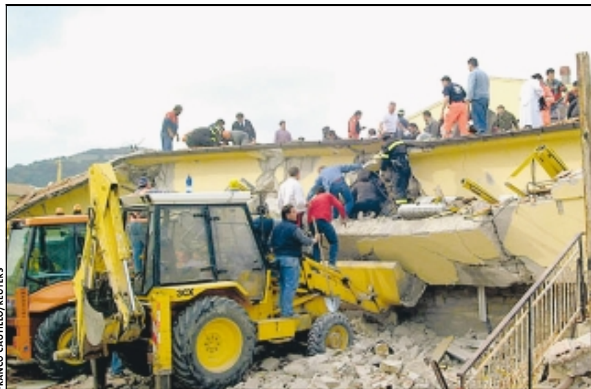
Des sauveteurs tentent de dégager les enfants bloqués dans les décombres de l'école de San Giuliano di Puglia, jeudi 31 octobre, après l'effondrement du bâtiment causé par une secousse sismique de magnitude 5,4 sur l'échelle de Richter.
